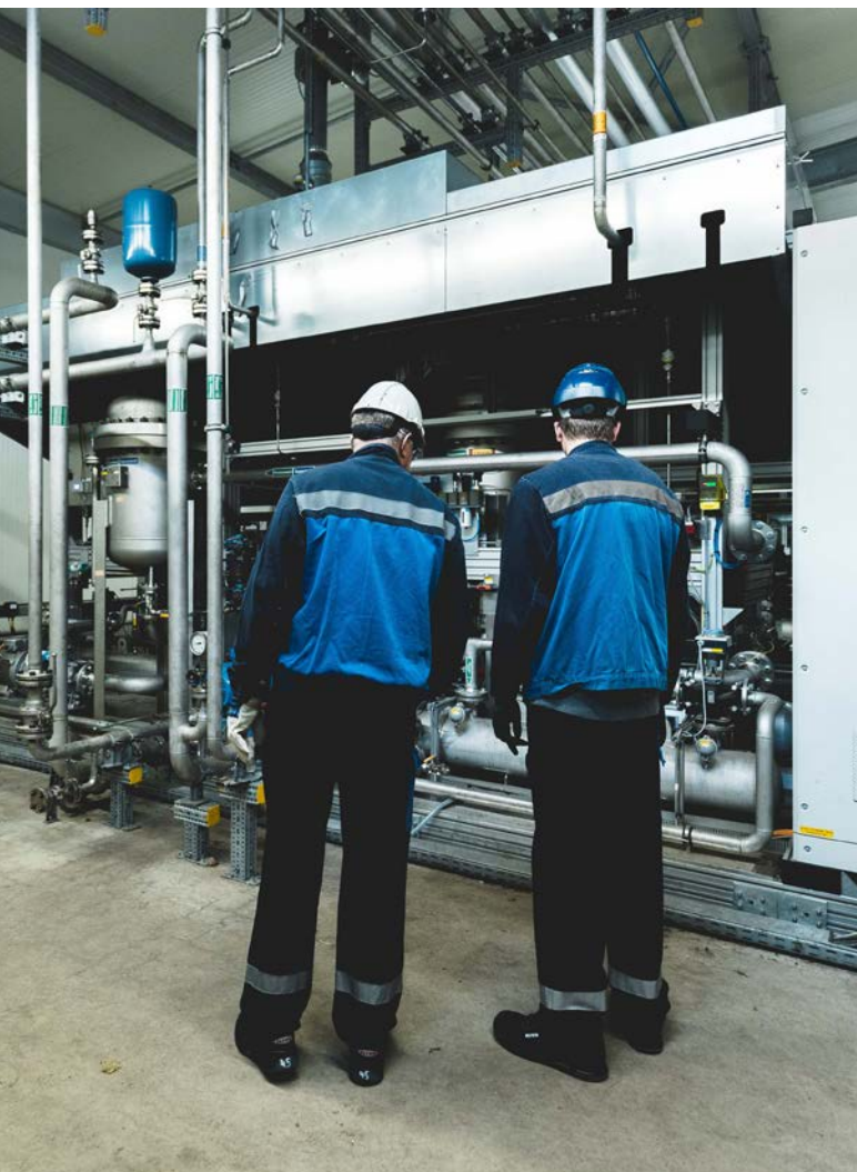
Abb. 29: Darstellung eines Elektrolyseurs bei H&R Ölwerke Schindler im Hamburger Hafen © Mediaserver Hamburg / DOUBLEVISION
