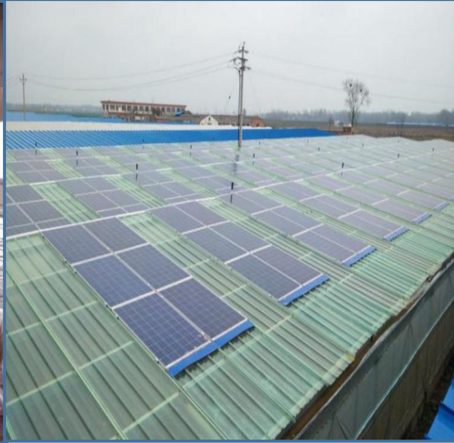
羊舍顶部光伏发电板
